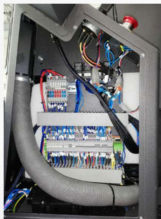
Cablaggio interno cabina
