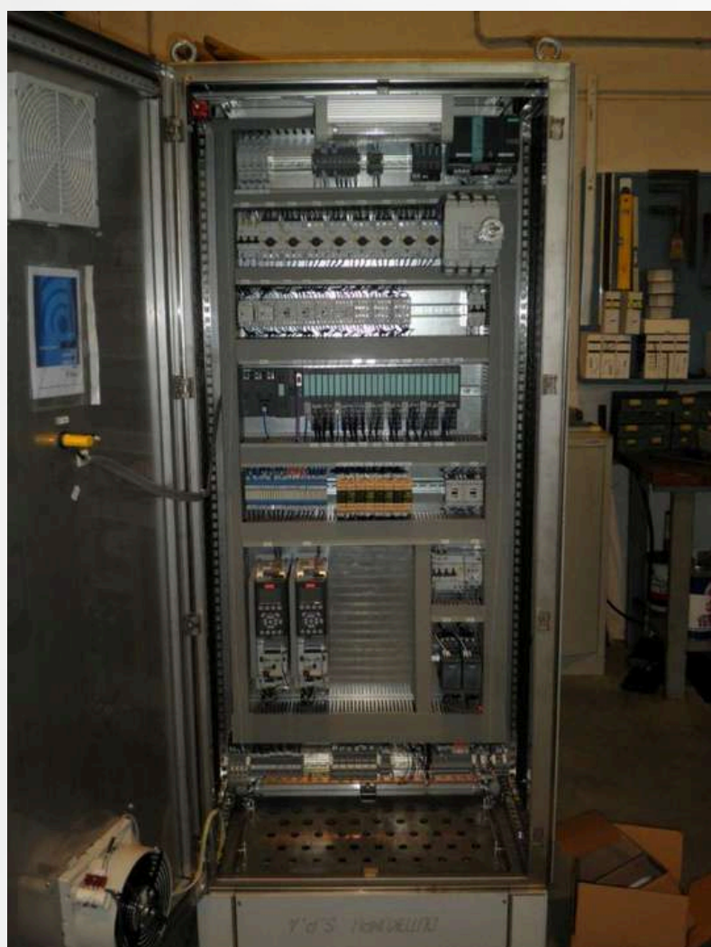
Quadro elettrico per impianto per linea lavorazione frutta
